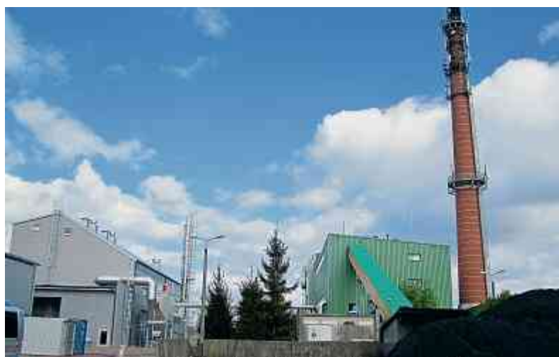
Biomasse statt Braunkohle: Das Holzbiomasse-Heizkraftwerk in Lebork (Polen) trägt zur CO 2 -NO x - und Feinstaubreduktion im Land bei.
